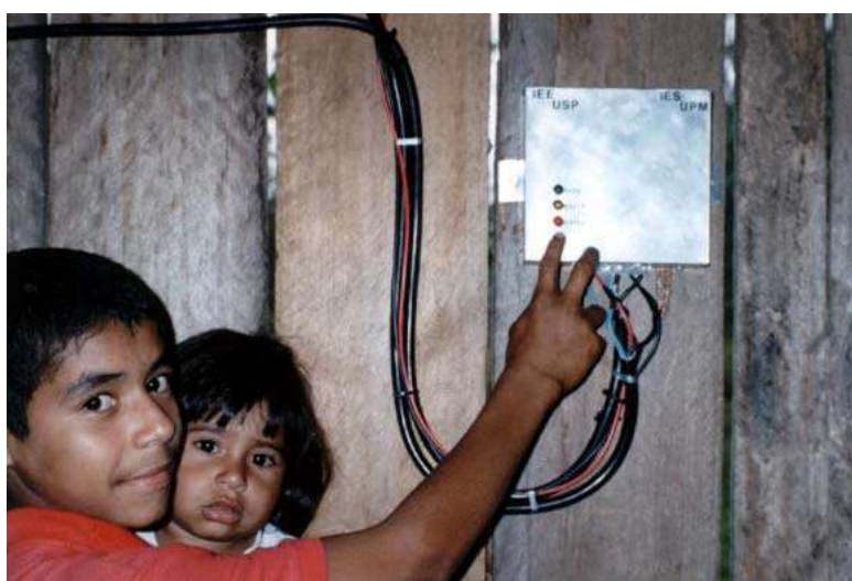
Figura 6.15 – Detalhe do controlador de carga.
